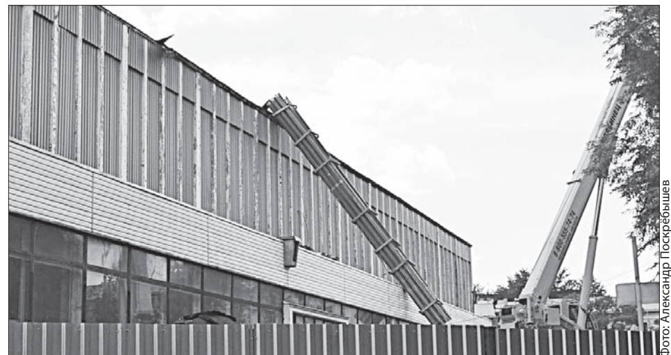
Первый этап реконструкции ЛД «Ижсталь»: строители снимают старое кровельное покрытие и утеплитель
